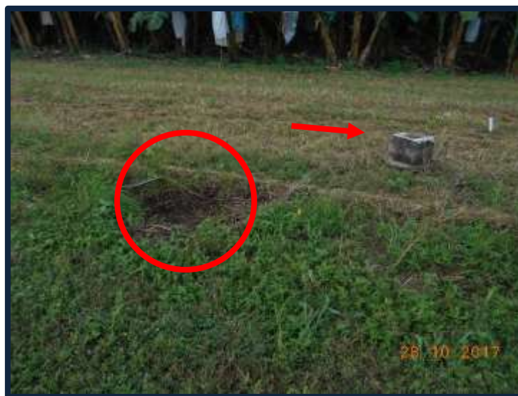
Fotografía No.: 14 Vista de la base de luz de pista arrancada al colisionar la aeronave.
